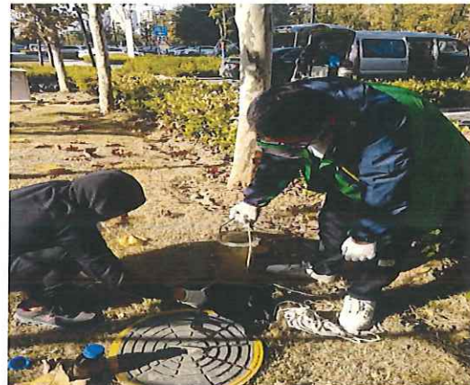
D5 栋废水出口★1
