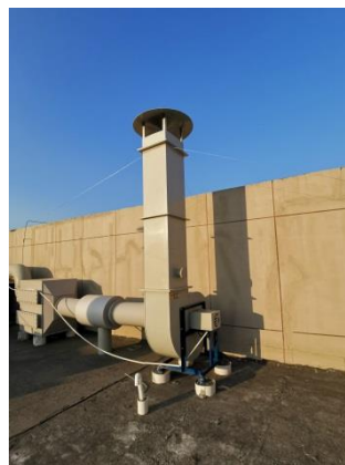
理化分析室排气筒
